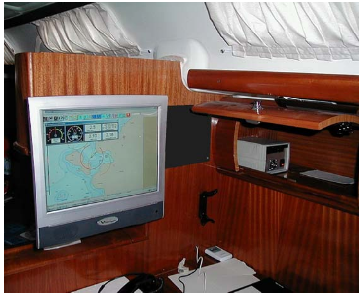
SeaCenter 3001 eingebaut im Seitenschapp am Navitisch in einer Bavaria 36 mit 15" – TFT Flachbildschirm
